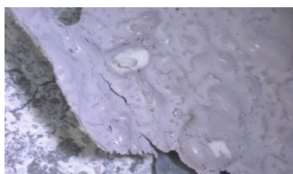
④剥離した仕上塗材
