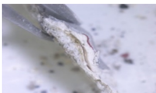
⑤仕上塗材の破断面
